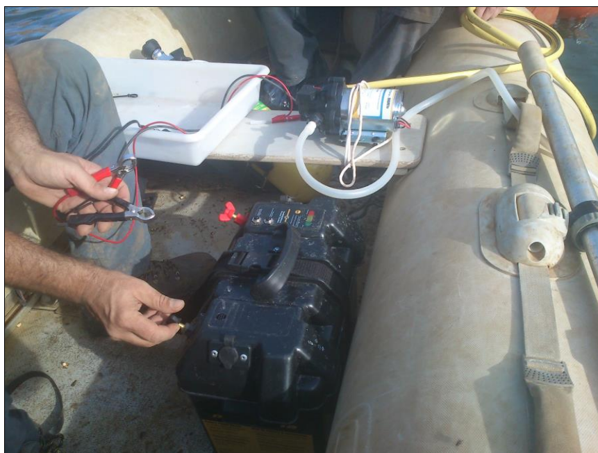
Figura 42. Bomba de succión y batería utilizadas para el purgado del primer dispositivo de desgasificación en Octubre de 2014.
