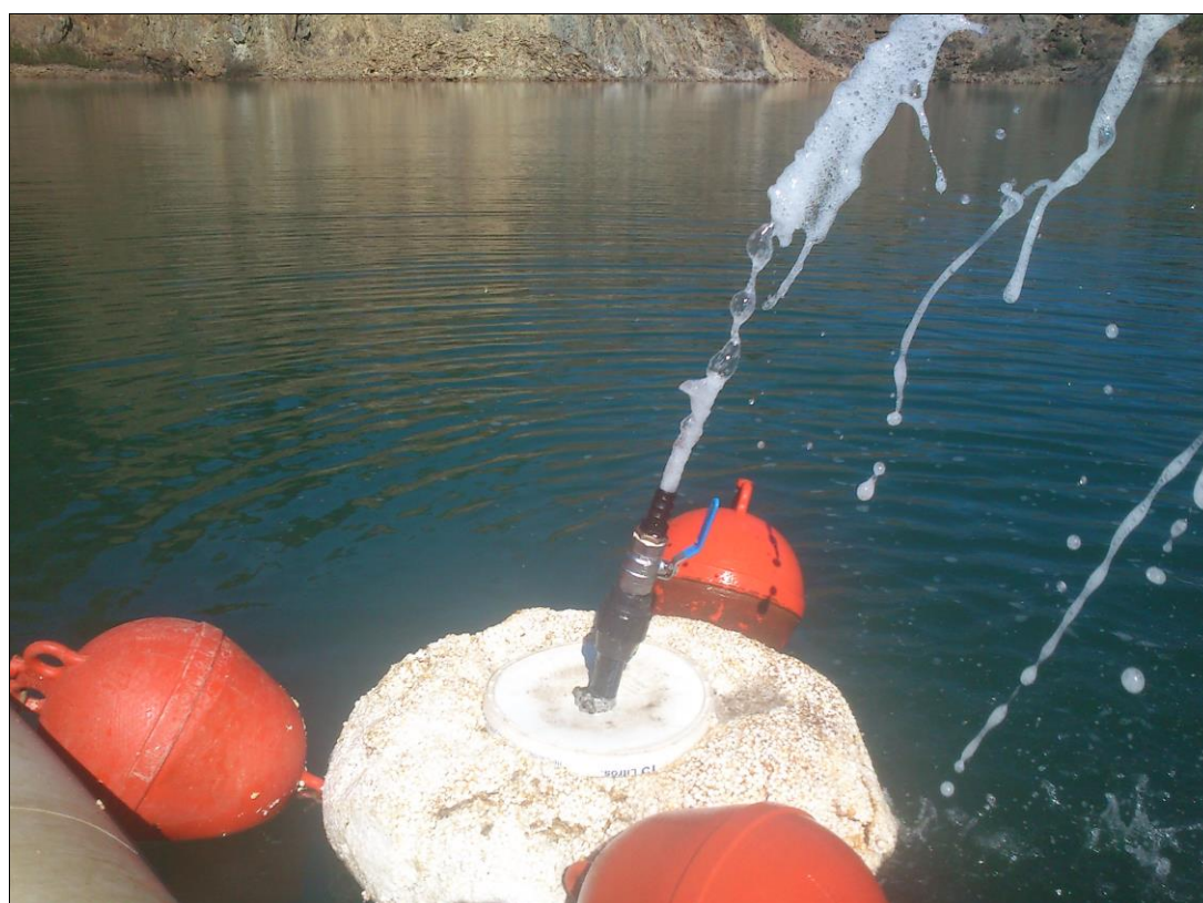
Figura 46. Aspecto del segundo dispositivo de desgasificación instalado en la corta Guadiana, ya funcionando (Octubre de 2014).
