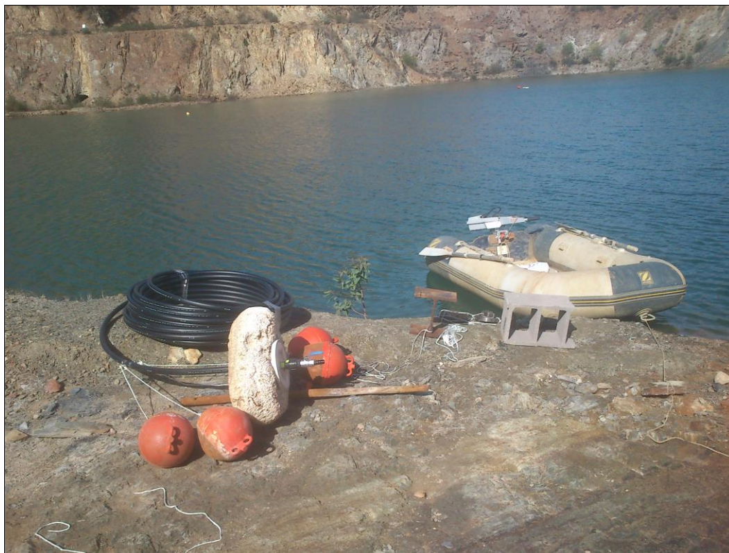
Figura 44. Montaje e instalación del segundo dispositivo de desgasificación en la corta Guadiana en Octubre de 2014.
