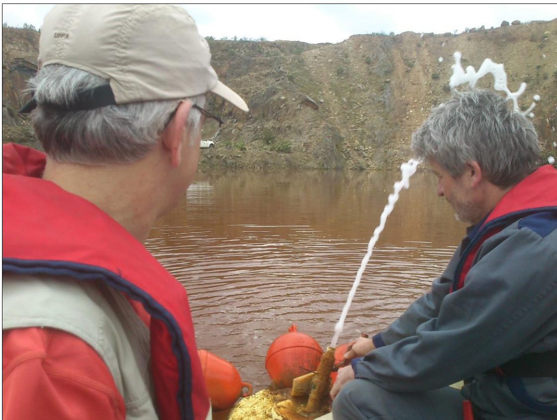
Figura 48. Inspección de llave de paso y otros elementos de una de las líneas de desgasificación en Abril de 2015, tras seis meses de funcionamiento.
